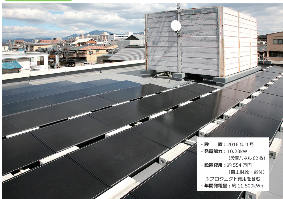
▲上鳥羽北部いきいき市民活動センターの屋上に設置されたソーラーパネル
