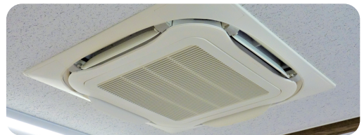
▲古いエアコンは消費電力が多い
